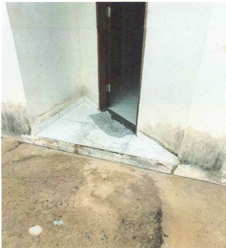
Porta de entrada da casa sem acessibilidade
